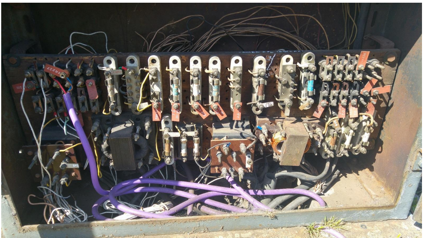
Armarios viejísimos con sistemas eléctricos montados sobre madera.
