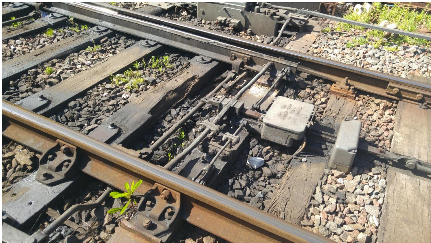
Cambios de vía ingleses.
