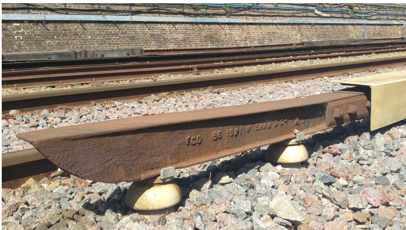
En el tercer riel electrificado, además de estar sin protección o tapa, se puede ver la edad la mayoría de los rieles en cruces de vías (1921).
