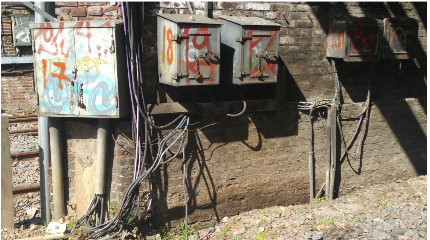
Cableado y armarios vetustos que necesitan una renovación total.
