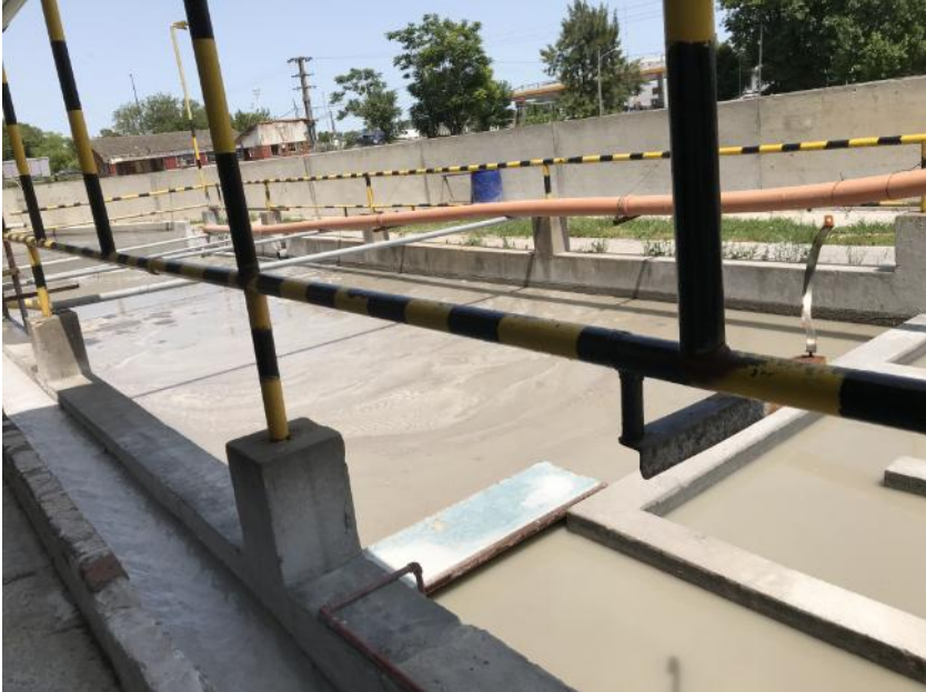
Figura 33. Pileta de efluentes que vuelcan en el arroyo El Gato. Fotografía propia.
