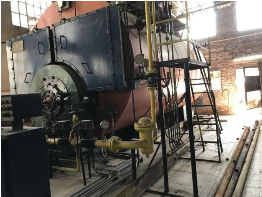
Figura 24. Sector calderas. Fotografía propia.
